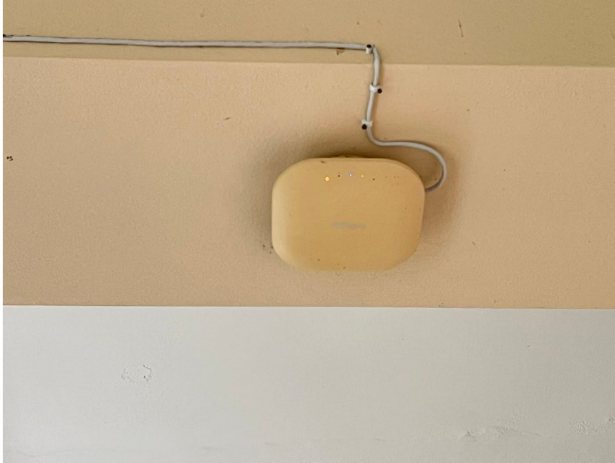
ตรวจเช็คอุปกรณ์เครือข่ายอย่างสม่ำเสมอ
